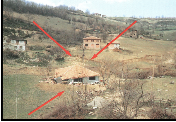
Şekil 16. Heyelâna maruz kalmış ve kullanılmaz hale gelmiş beton bir ev (Kaynak: KUTERDEM ve TEMİZ 2001).
