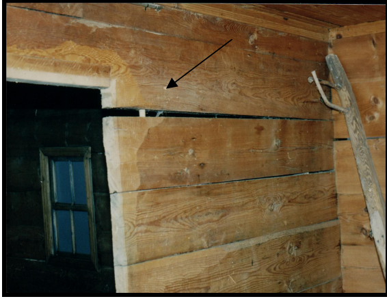
Şekil 8. Babaköy’de heyelândan zarar gören bir konutun içten görünümü. Fig. 7. A view from inside the house that was affected by landslide.
