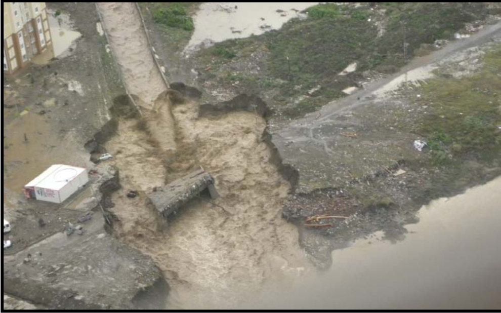
Foto 6. 4 Temmuz 2012 tarihinde Yılanlıdere'nin Mert Çayı'na karıştığı yere yakın bulunan köprü sel sularının etkisiyle yıkılmıştır.
