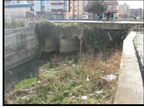
Foto 6. Mansap tarafında menfezdeki göz sayısı ikiye indirilmiş ve çıkışları duvara yönlendirilmiştir.
