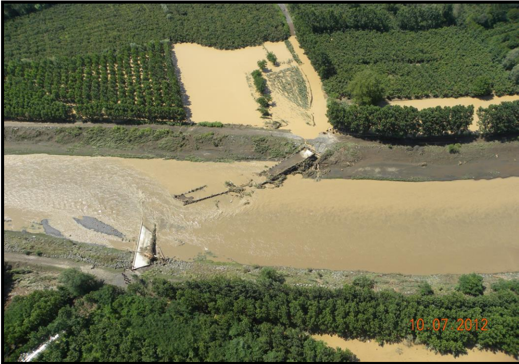
Foto 2. 9 Temmuz 2012 tarihinde Terme Çayı'nın orta çığırında etkili olan taşkında akarsu üzerinde bulunan çok sayıda köprü yıkılmıştır.
