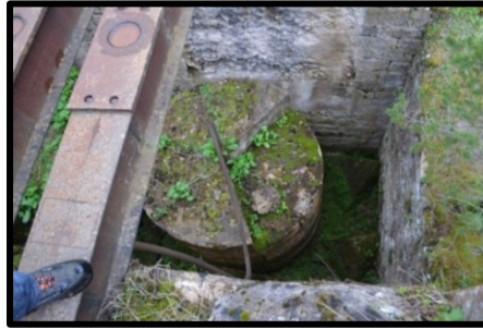
Şekil 56: Çukurçay'da telleri geren manivelanın beton ağırlık sistemi.
