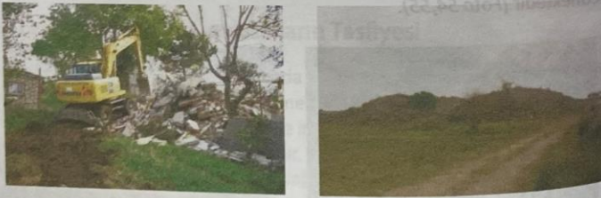
Foto 58-59. a) Kaçak yapıların Büyükşehir ekipleri tarafından yıkılması, b) Molozlardan oluşturulan, sonrasında doğal çevreye uymadığı gerekçesiyle ortadan kaldırılan seyir tepeleri.
