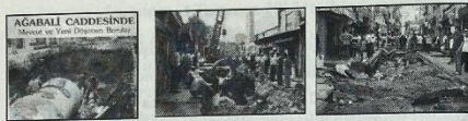
Şekil 16. 1994'teki alt yapı çalışmalarından görüntüler (a,b). 2007'de meydana gelen selde Ağabali Caddesi'nin sel sonucu tekrar büyük ölçüde tahrip olması (c).
