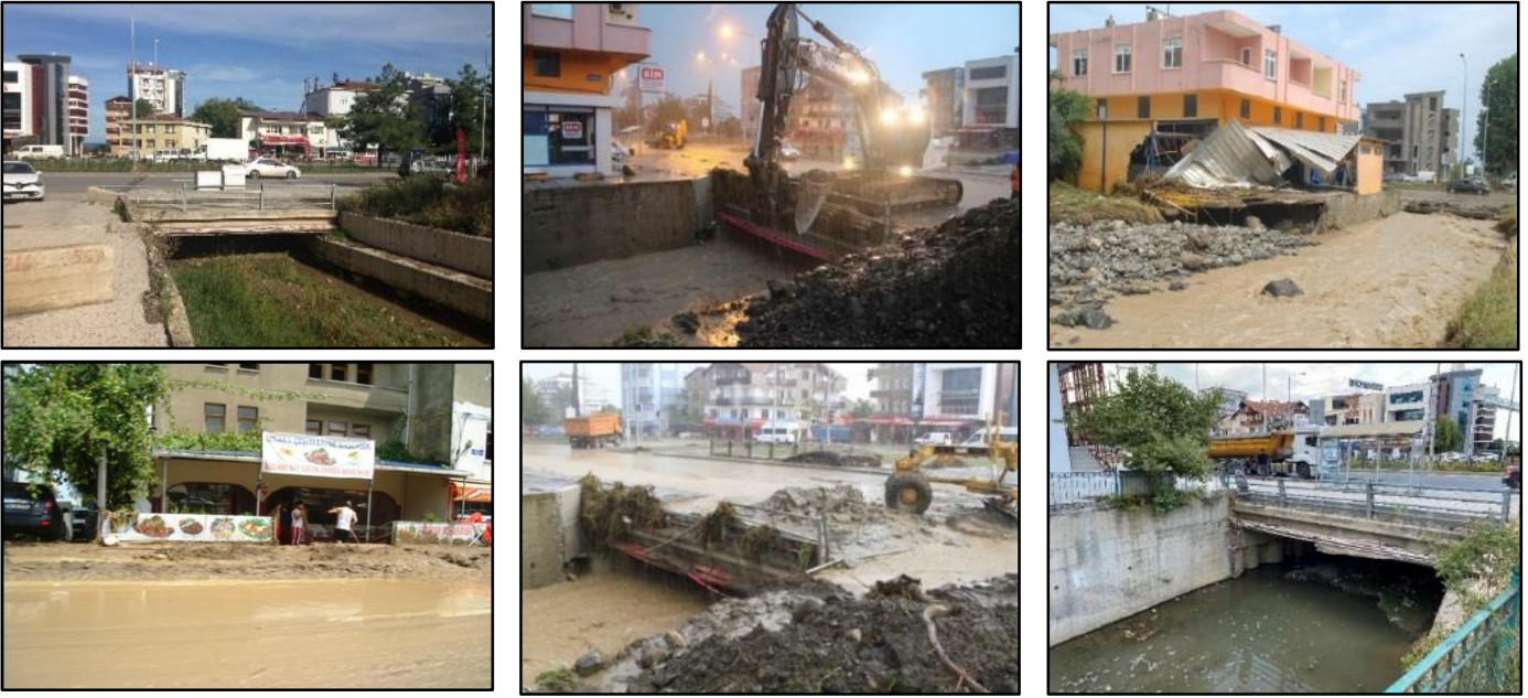
Şekil 8. Atakum-Pelitköy kavşağı. Değirmendere'den gelen sel suları karayolunun altındaki menfezden geçemeyince yola taşı. Sel öncesinde çekilen foto geçidin ne kadar alçak ve dar olduğunu zaten gösteriyor (a). Menfezin tıkanıp daha büyük risk oluşturmasını engellemek için sel esnasında bir kepçe sürekli çalışmak zorunda kaldı (b), fakat yine de yol ve işyerlerini zarardan kurtaramadı (c,d,e). Menfez bugün! (f).
