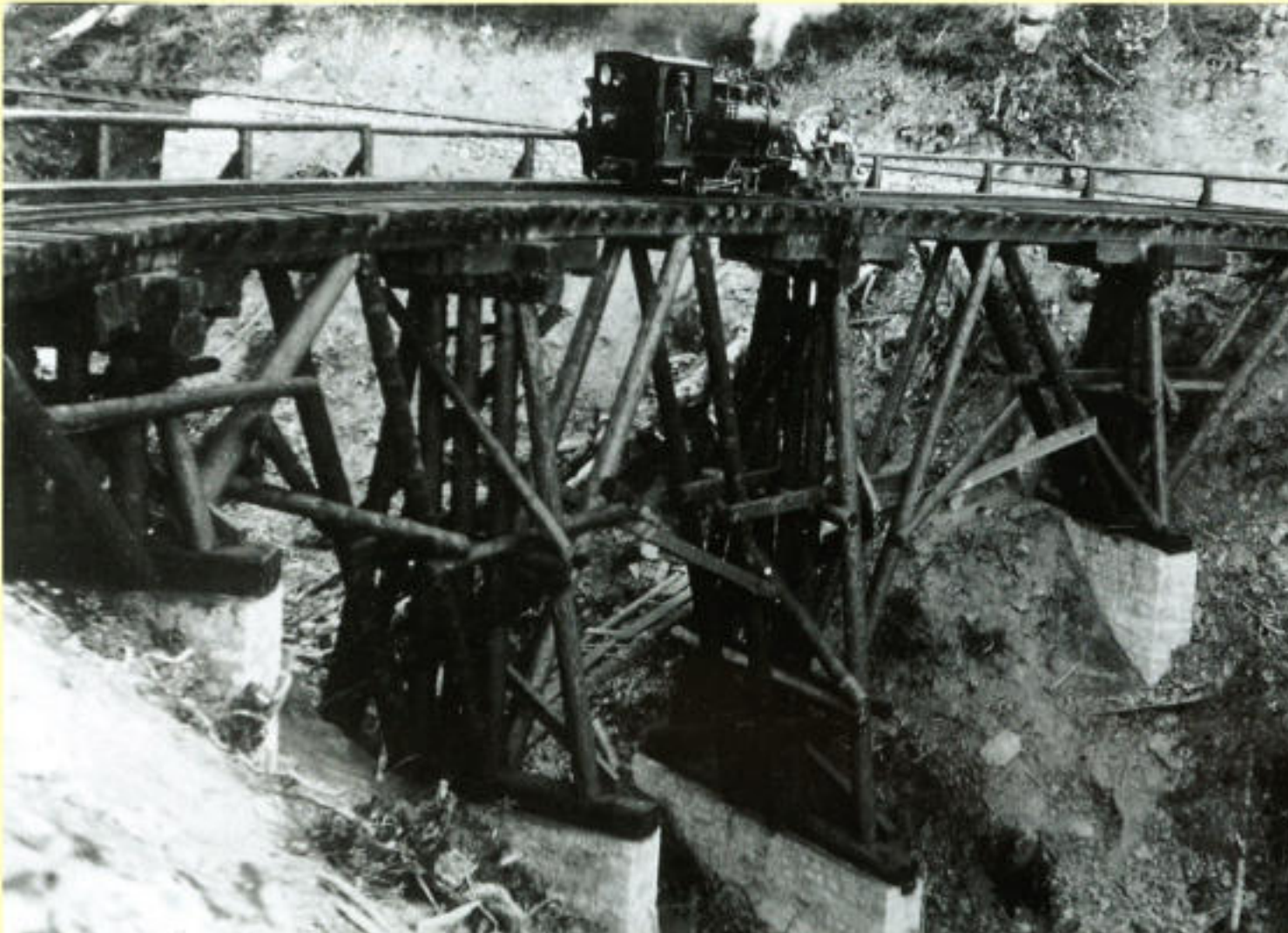
Abb. 57: Waldbahnbrücke in der Kurve ( R = 30 \text{ m} ). Gehweg und Geländer an der Außenseite der Kurve. Einfache Sperrwerke (F. Hafner). Die Brücke aus Abb. 54 in einer anderen Ansicht. Man beachte den B-Kuppel
