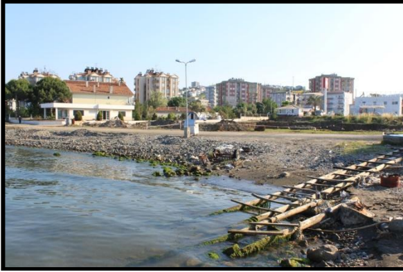
Foto 8. Körfez mahallesinde kıyı kenar çizgisi ihlal edilerek açılan bir inşaat temeli (Haziran 2011).
