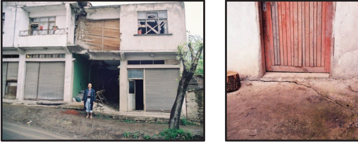
Foto 23-24. Korakpınarı mahallesindeki heyelanlar sonucu tahrip olmuş meskenler; a) Zemindeki kayma nedeni ile evin bölümleri arasında ortaya çıkan seviye farkları, b) çatlamaya devam eden meskenler.
