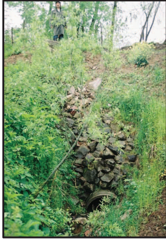
Foto 5. Yer altı suyunu besleyen bir diğer kaynak da yetersiz altyapı şebekesinin sebep olduğu kaçaklardır.
